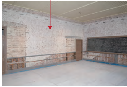
【写真7】本館：復原教室の壁に煙突が無い
