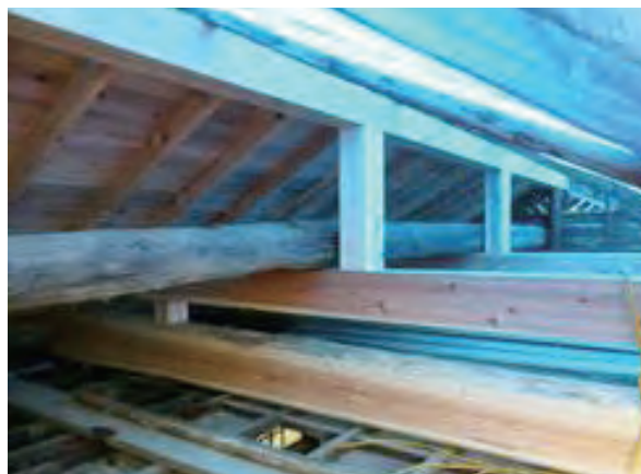
洋間小屋組補強 撮影坂田
