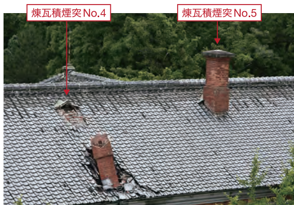
【写真3】 本館：屋根廻り・煉瓦積煙突の破損状況
