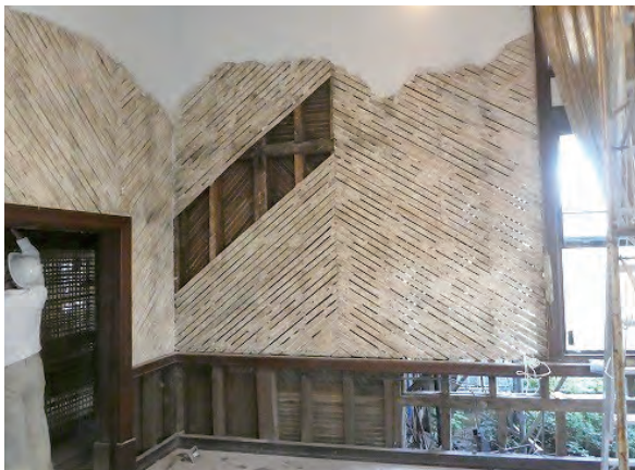
洋間漆喰壁剥落状況 撮影坂田
