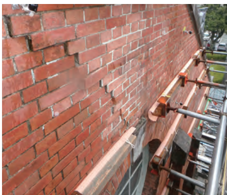
【写真8】旧機械実験工場：ひび割れの状況
