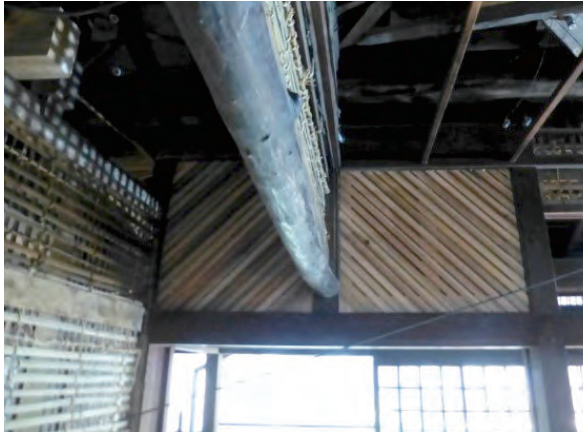
10 帖付書院 欄間補強 撮影坂田
