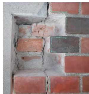
【写真1】化学実験場： 煉瓦工事煉瓦補修前
