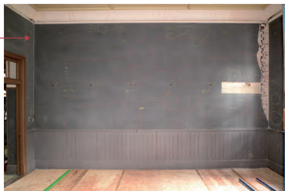
【写真13】 本館第2企画展示室：漆喰仕上げ面に生じた亀裂の状況
