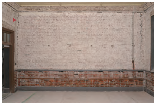
【写真14】 本館第2企画展示室：漆喰塗りを解体して煉瓦躯体に生じた亀裂の状況
