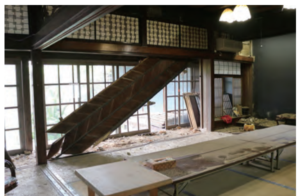
【写真5】地震の被災状況 地震で縁側の天井がおち、土壁が崩れた塩屋
