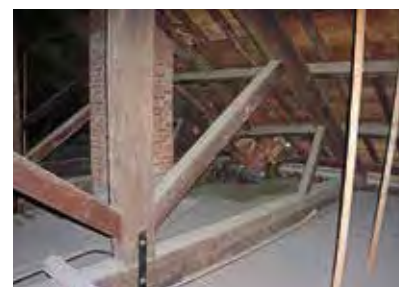
折れた煙突が突き刺さった屋根裏
