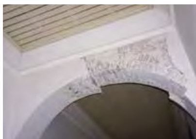
漆喰の落ちたアーチ
