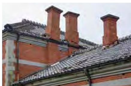
折れたものの辛うじて屋根に残った煙突
