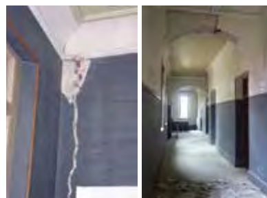
左：壁の亀裂 右：アーチから崩落した漆喰が散乱する廊下
